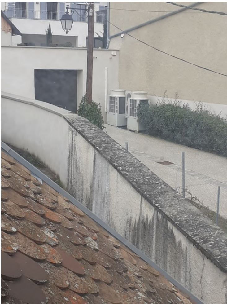
Vue de l'habitation 2 PAC+1climatiseur Rue très calme
